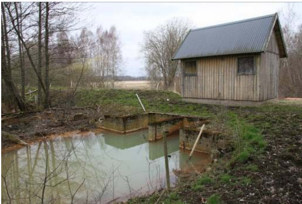
Bild. Torseke-Fredriksdals invallningsförrättning, 1950. Bilden visar pumpstationen till höger i bild och den södra delen av vallen som vetter mot Fredriksdalsvikens naturreservat.
